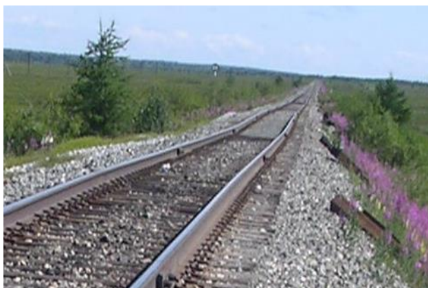
Рисунок 1 – Участок с просадками пути на линии Чум – Лабитнанги
